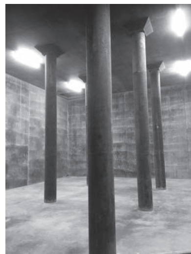
Abb 1: Trinkwasserkammer Reservoir Wertbühl
