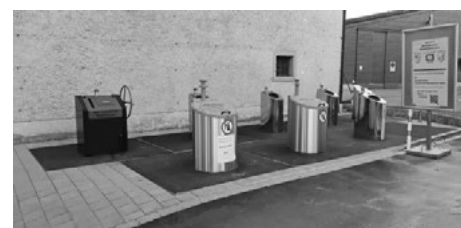
Abb 4: UFC-Anlage Werkhof Bürglen
